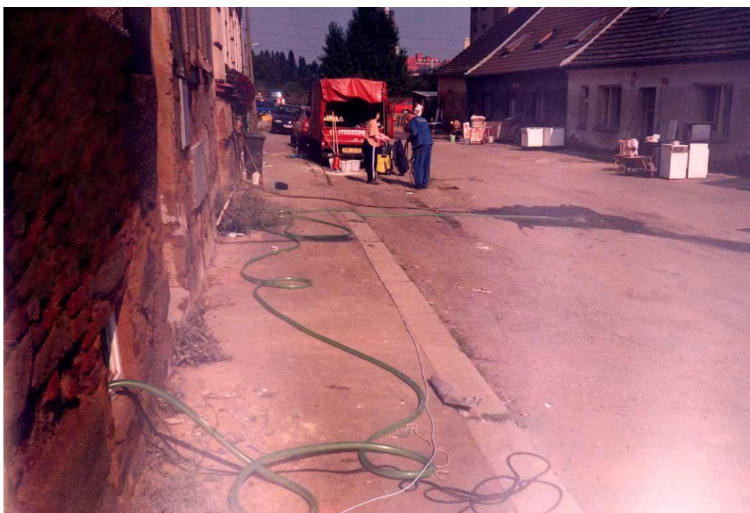
Takto vypadala „práce v terénu“ – zasažená čtvrť Roudná
